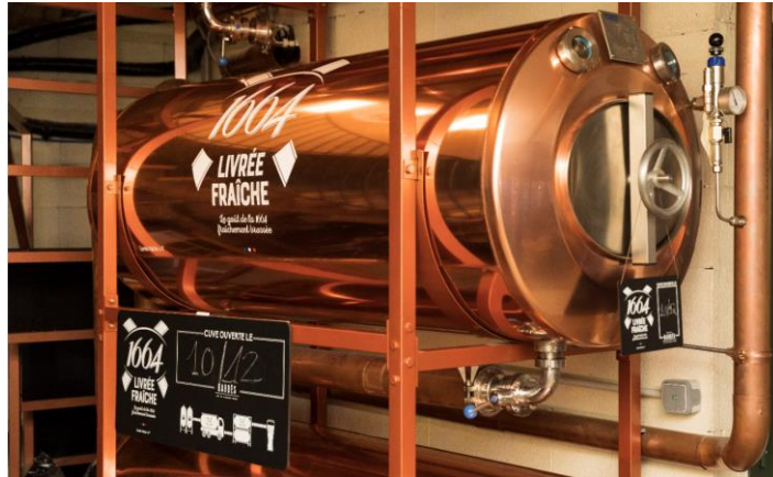
Cuve en inox de 5hl
